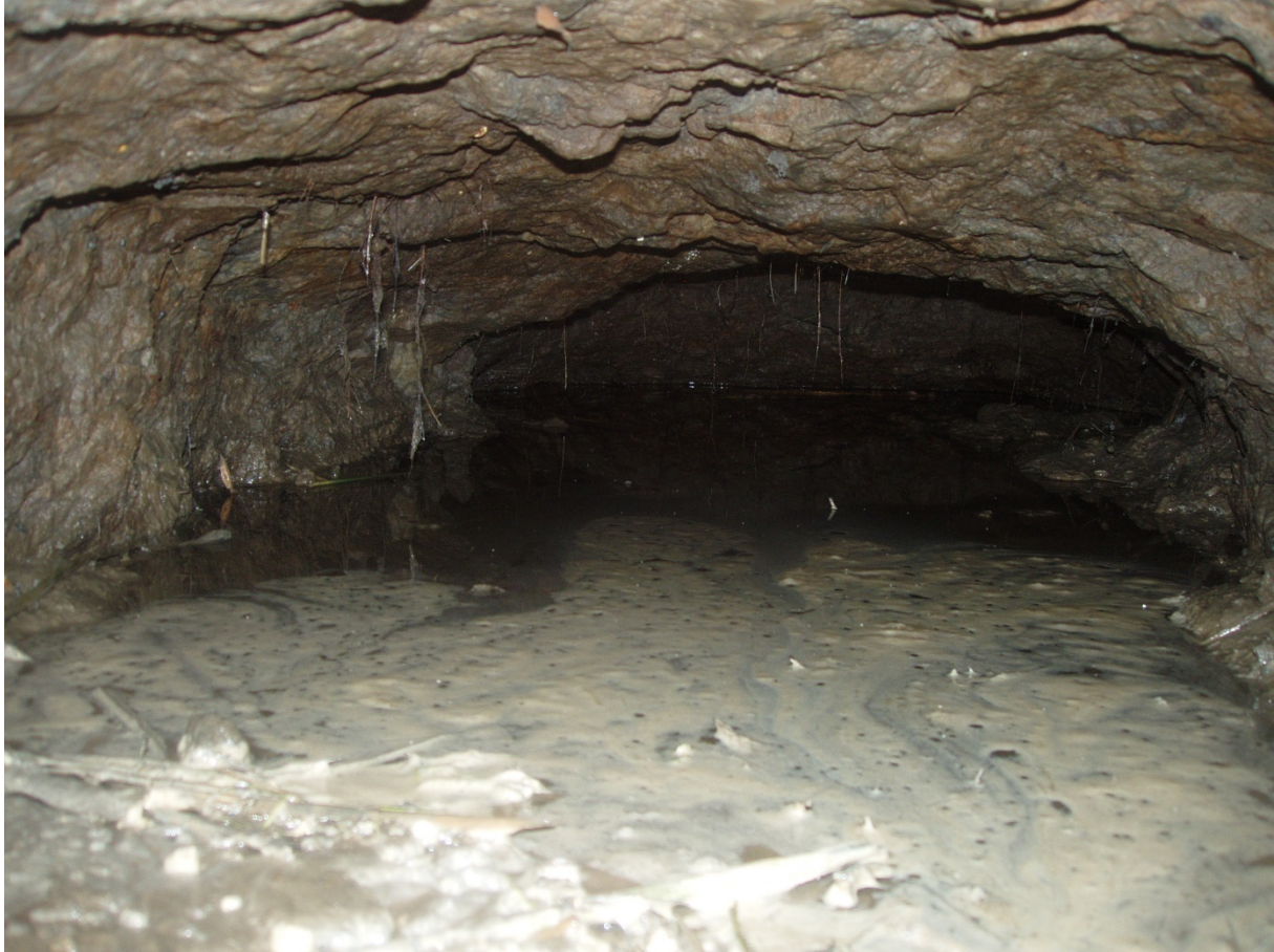
Figuur 7.3. Bevergang in de primaire waterkering bij Waalwijk, omvang circa 1 bij 0,4 m (foto: Vilmar Dijkstra).
