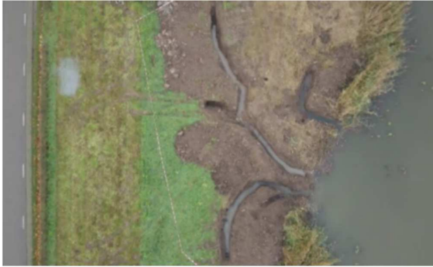
Figuur 4 Bevergraverij vanuit buitendijks water tot in primaire waterkering, IJsseldijk Veessen 2022. De langste gang was 18 m.
