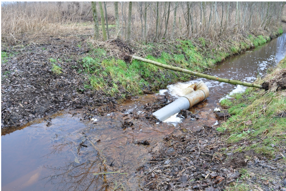
Afbeelding 14 : Flow Device op kaskadestuw (linkerkant)
