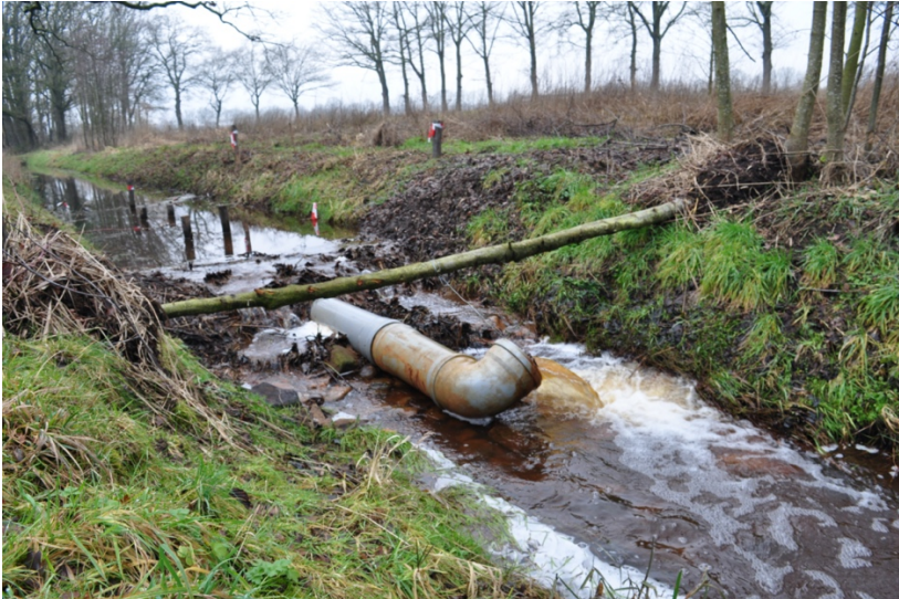
Afbeelding 12 : Flow Device op kaskadestuw (rechterkant)
