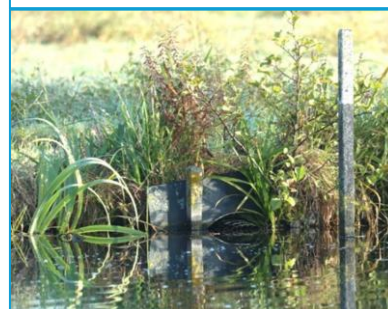
Afbeelding 16: Schijnduiker geplaatst in de oever (foto, onbekende maker, z.d).
