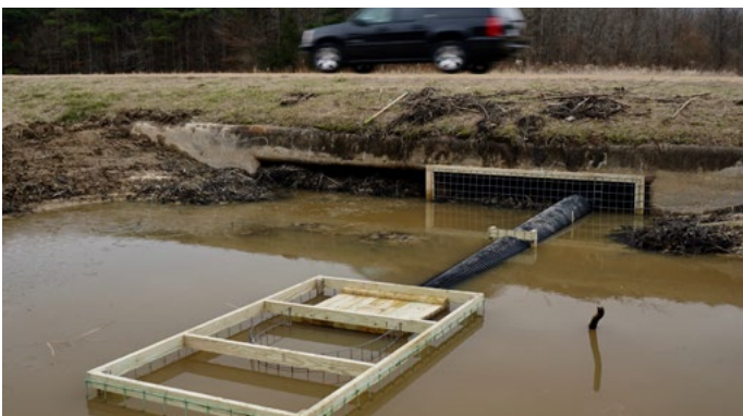
Afbeelding 5. Gaas voor een duiker om te voorkomen dat een bever het dichtstopt met takken en modder, waarbij een verlenging met een buis en filter is toegepast. De foto geeft de situatie bij normale waterstanden (S. Lisle).
